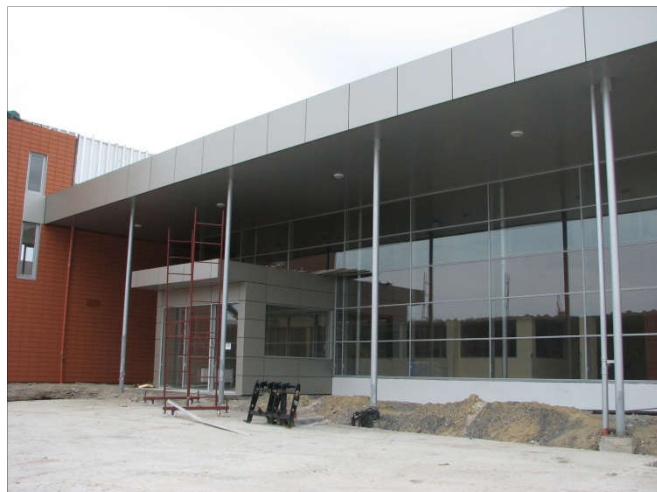
Заказчик: Мироновский Хлебопродукт Адреса г.Черкасы Выполненные работы: Остекление и облицовка фасада здания
